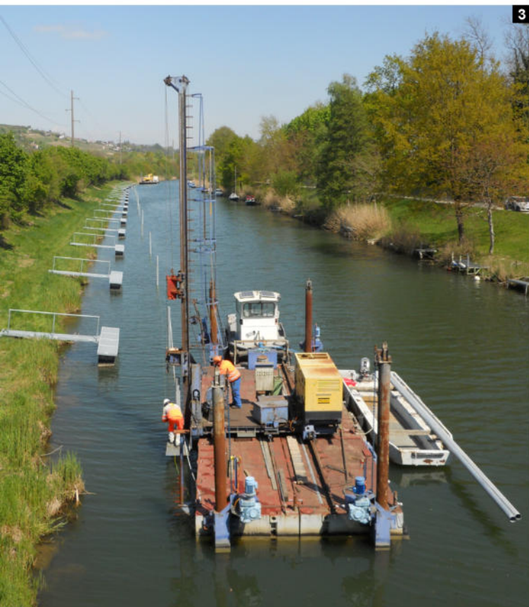
1. Réparation ponctuelle de la berge 2-3. Fonçage de pieux d'amarrage et montage des pontons flottants
