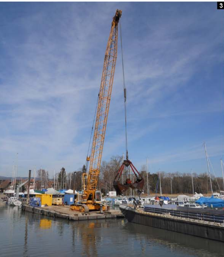
1.2.3. Dragage depuis ponton Flexy-float avec pelle à câble Liebherr 853 HD. Chargement et noyage des sédiments par chaland.
