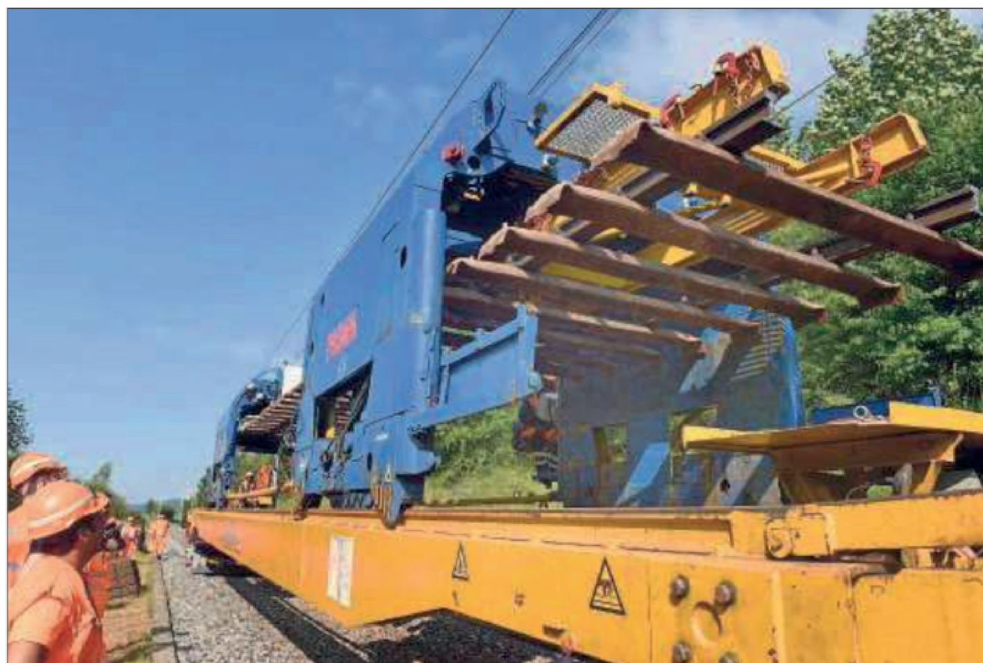
La machine Puma 2 peut soulever de terre des segments de voie de 18 mètres de longueur. PHOTO STÉPHANE GERBER
